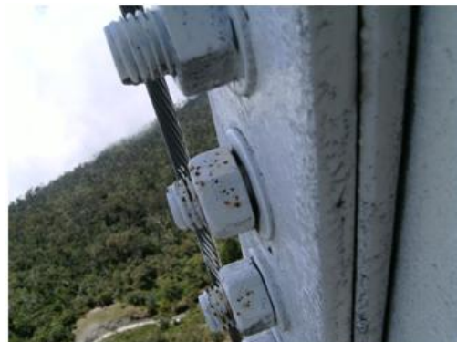
Foto 10. Detalle de tornillos con falta de torque
