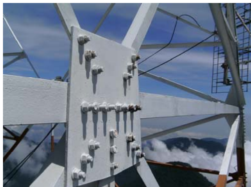
Foto 9. Detalle de unión, tornillería corta, sin apriete y presencia de corrosión.
